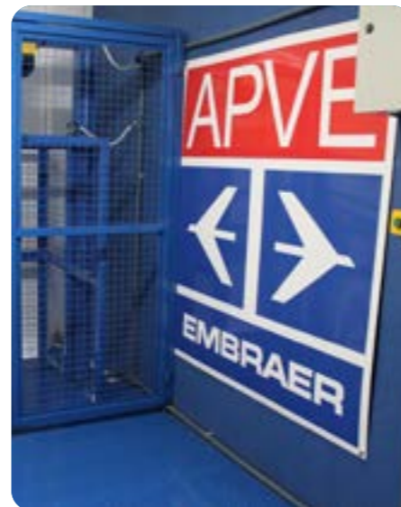
Elevador de carga
